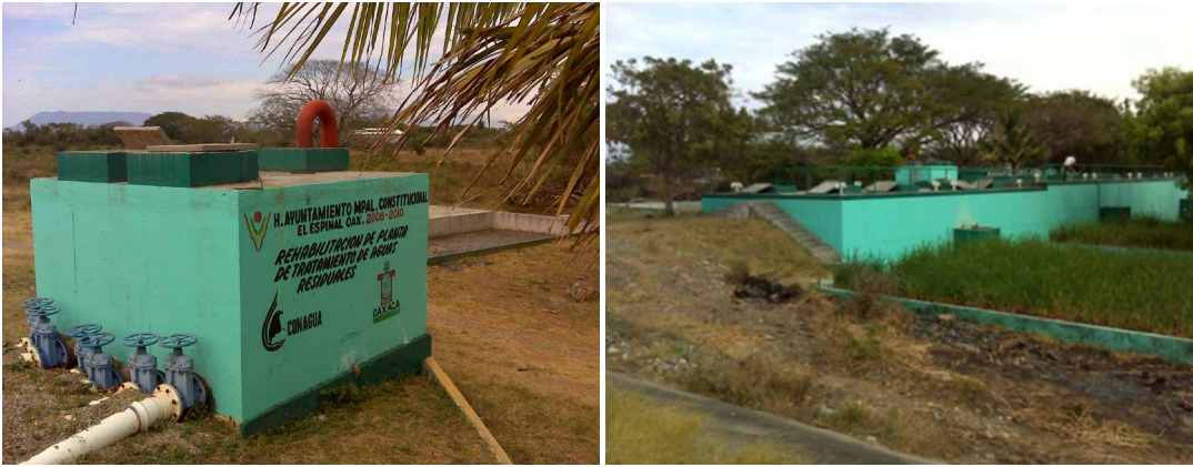
Foto 4. Planta de tratamiento de aguas residuales en El Espinal en 2010.
